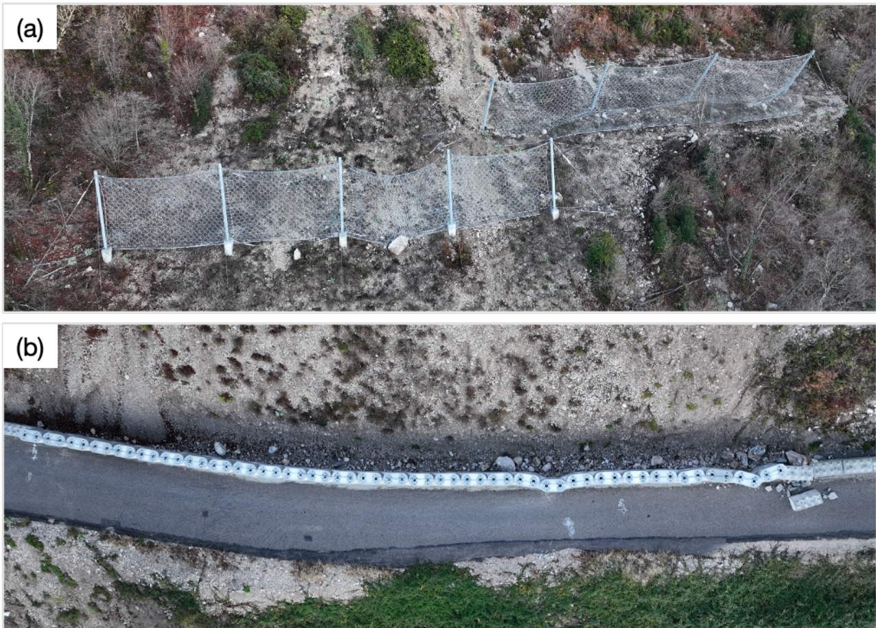
Figure 6. a) Vue aérienne des deux écrans de filet pare-blocs en versant, avec bloc de 1 m 3 arrêté dans un module de l'écran sur réhausse (Géolithe, 15/12/2023). b) Vue aérienne de l'ouvrage poids en blocs béton liaisonnés, avec déplacement horizontal suite à impact (Géolithe, 15/12/2023)
