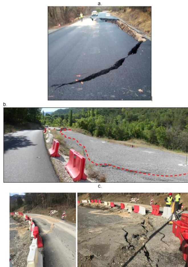
Figure 2. Évolution du glissement : (a) activation initiale en janvier 2018, (b) réactivation à l'été 2020, (c) progression du glissement en février 2021.
