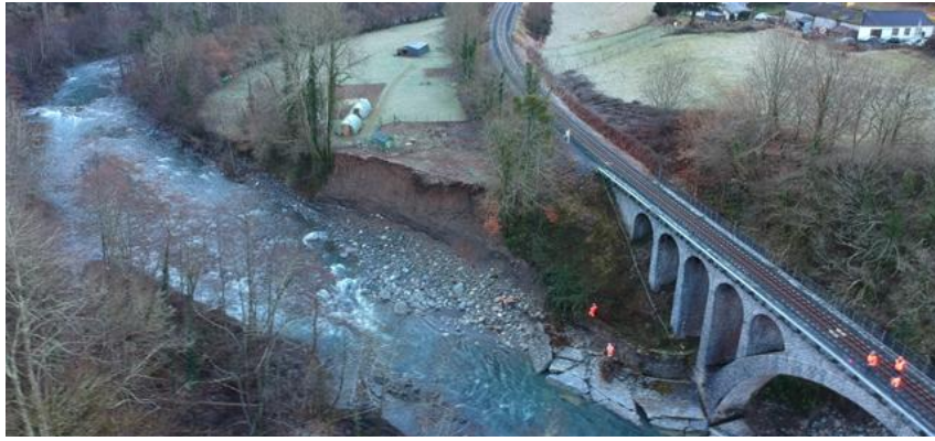
Figure 1. Vue générale de l'affouillement et de la ruine du perré au niveau du viaduc de Sarrance.
