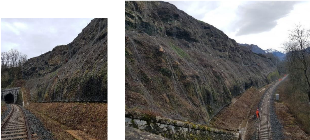
Figure 13. Vue générale des travaux en cours de finition sur le déblai de l'Araou
