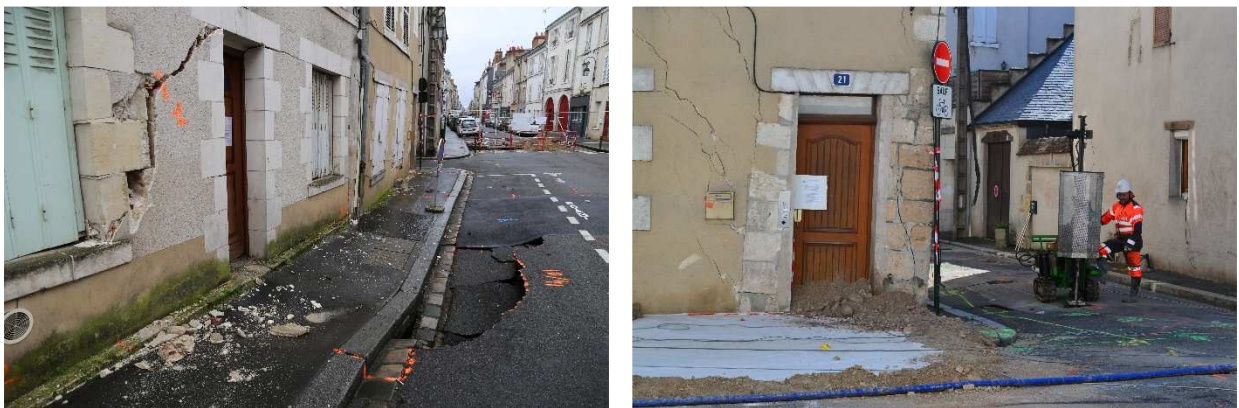
Figure 1. Mouvement de terrain du mois de janvier 2022 et investigations géotechniques légères
